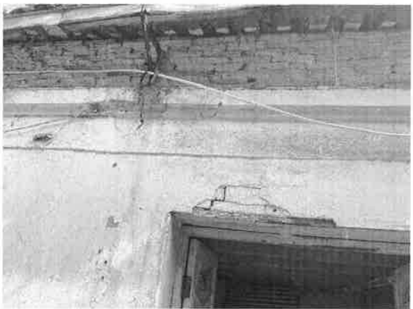
照片 12. 一层 4-5 交 B 轴门洞上方墙体开裂
