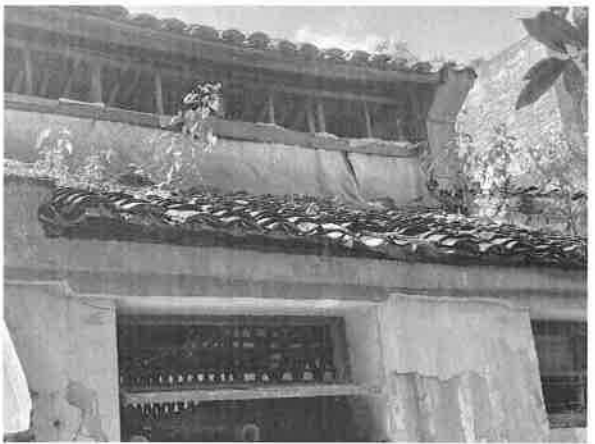
照片 18. 屋面老旧变形
