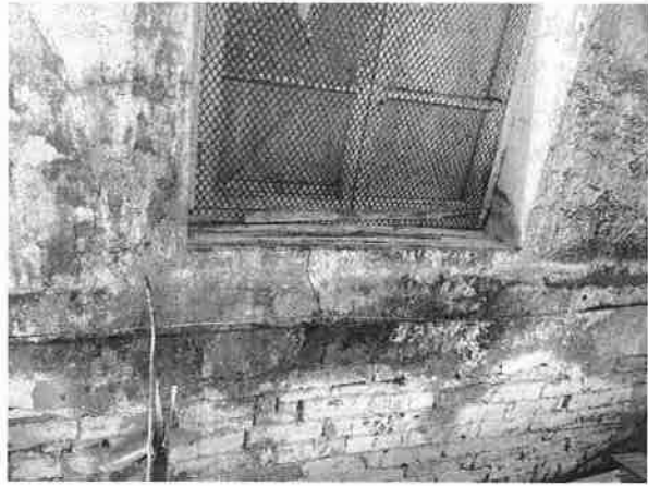
照片 14. 一层 4-5 交 B 轴窗洞下方 墙体开裂
