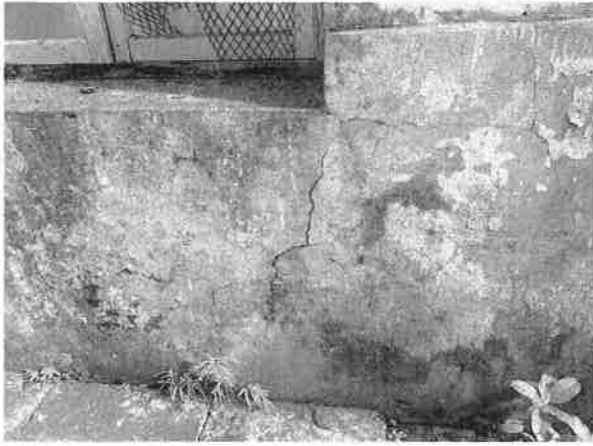
照片 13. 一层 4-5 交 B 轴窗洞下方 墙体开裂
