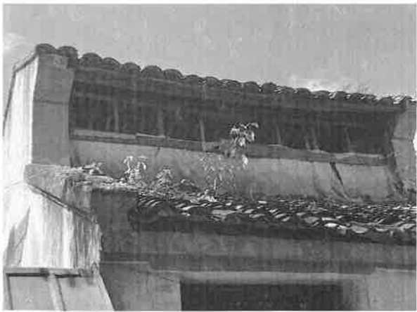
照片 17. 屋面老旧变形
