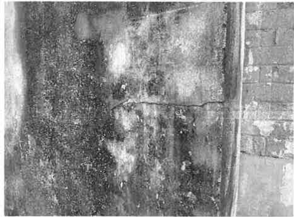
照片 4. 一层 5-6 交 A 轴墙体斜向裂缝
