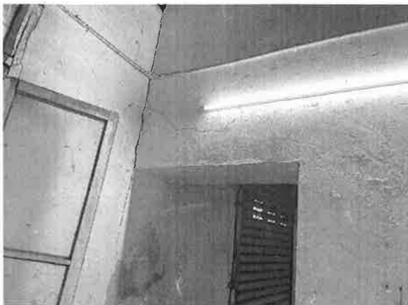
照片 5. 一层 A-B 交 4 轴门洞上方墙体开裂
